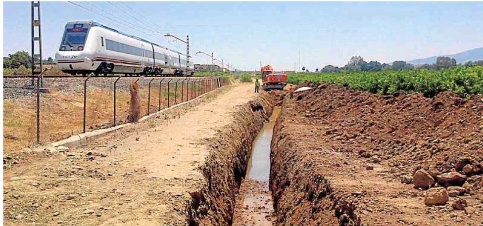
Los trabajos para la instalación de los colectores ya han comenzado, y en breve está previsto que arranquen los de la depuradora. :: SUR
